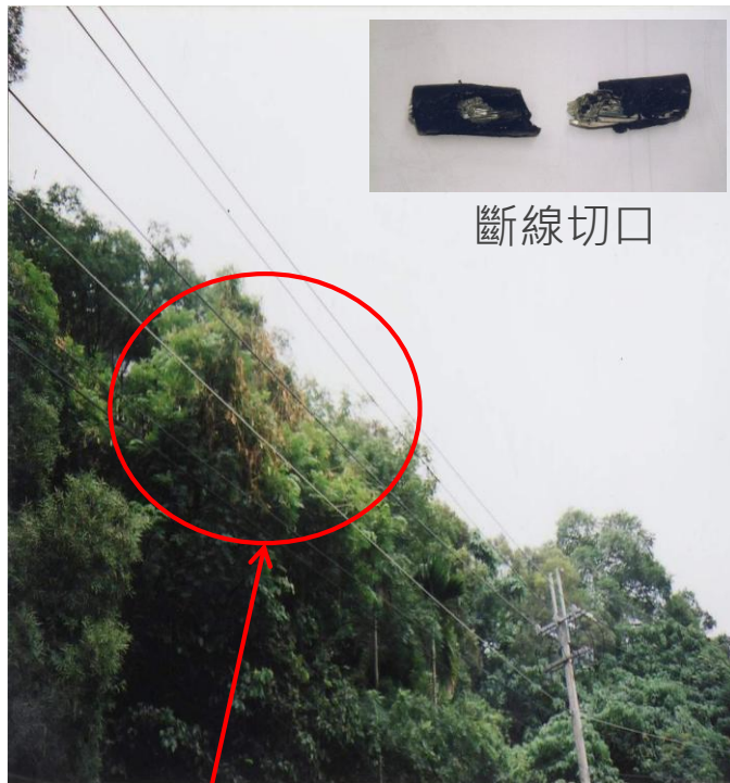
樹木碰觸高壓 被覆線燒焦痕跡
