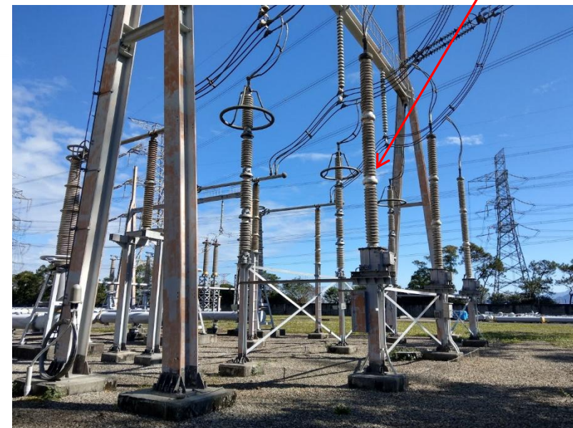
線路側比壓器
