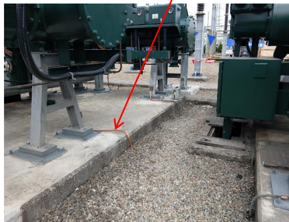
設備及構架接地
