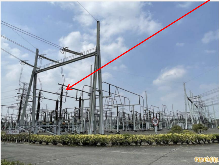
龍崎超高壓變電所
