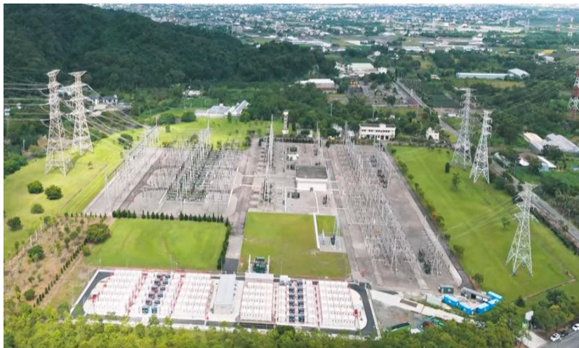
冬山超高壓變電所(E/S)儲能系統
