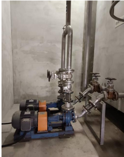
冷卻水塔下水池抽水馬達
