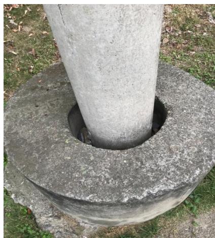
水泥管疊接電桿
