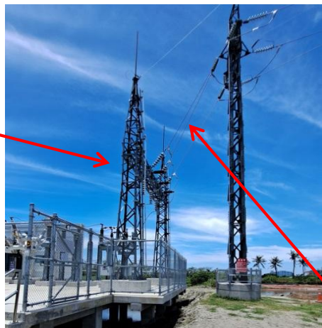
屋外式升壓站
