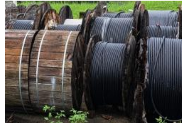
配電高壓電纜
