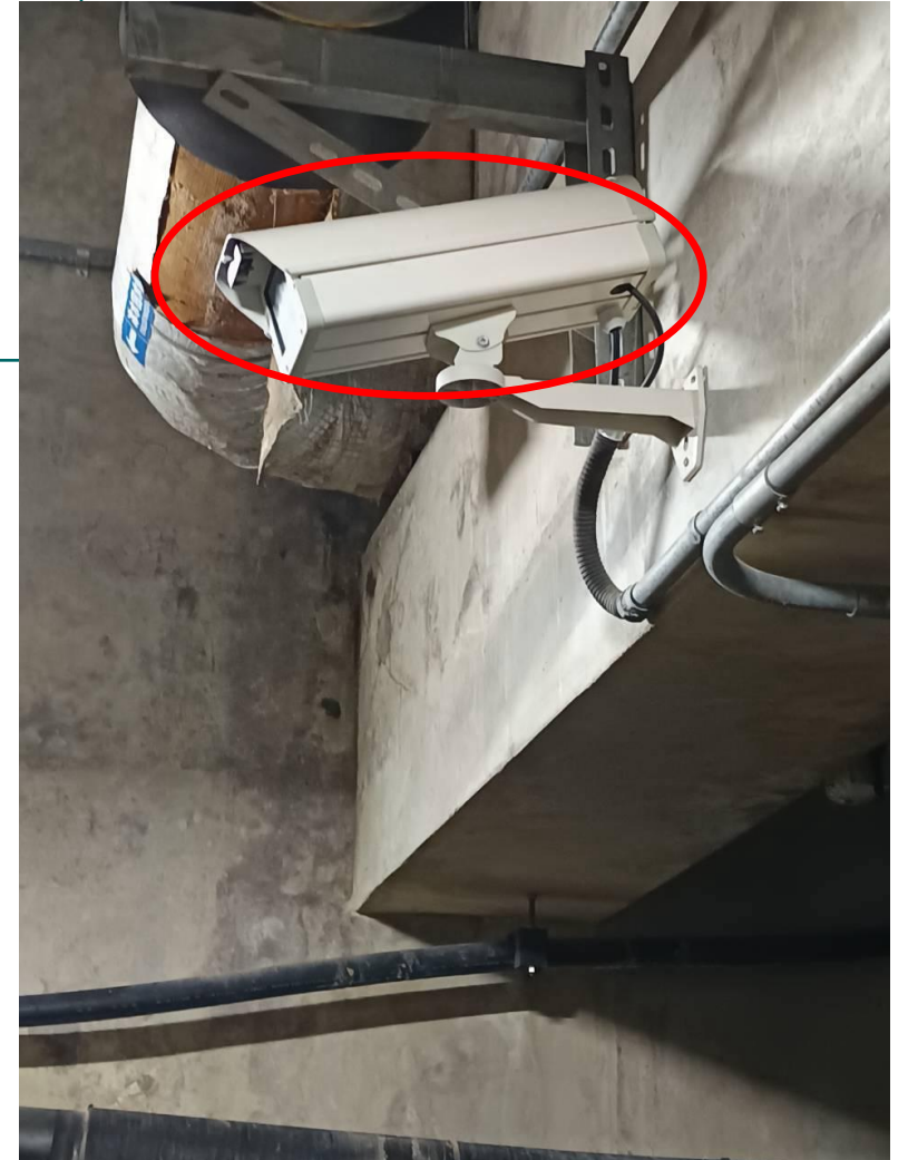
洞道內監控設施
