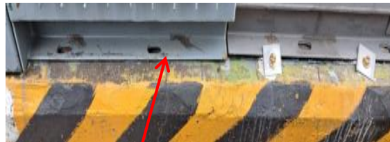
未固定，須補強
