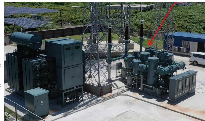
線路側比壓器
