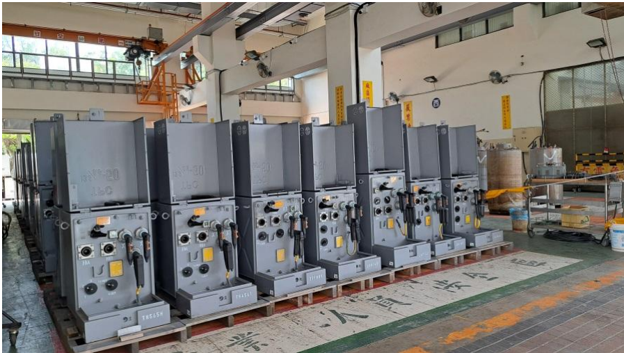
亭置式變壓器
