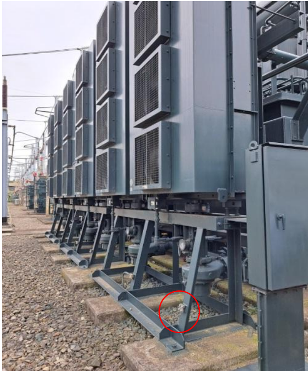
變壓器散熱風扇支架
