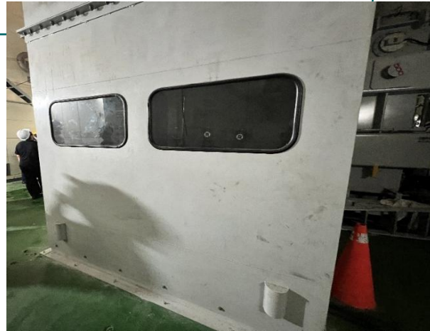
所內變壓器封在鐵外罩內
