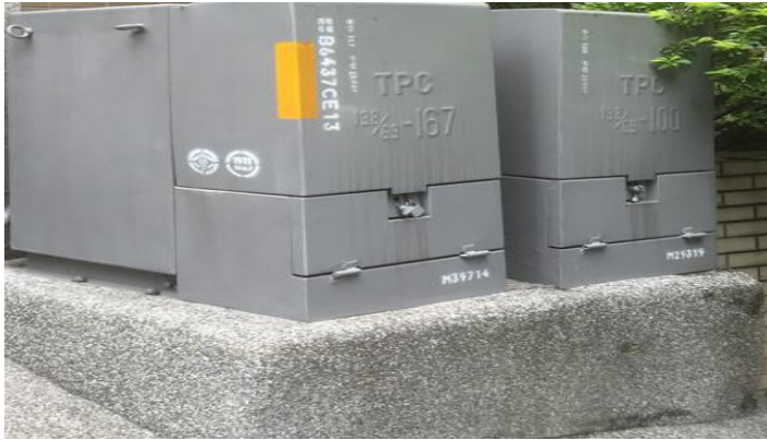
設備固定在基礎台
