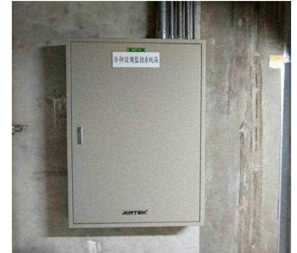
冷卻設備檢控系統箱
