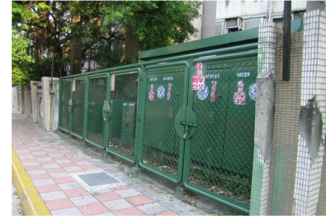
地面配電場所
