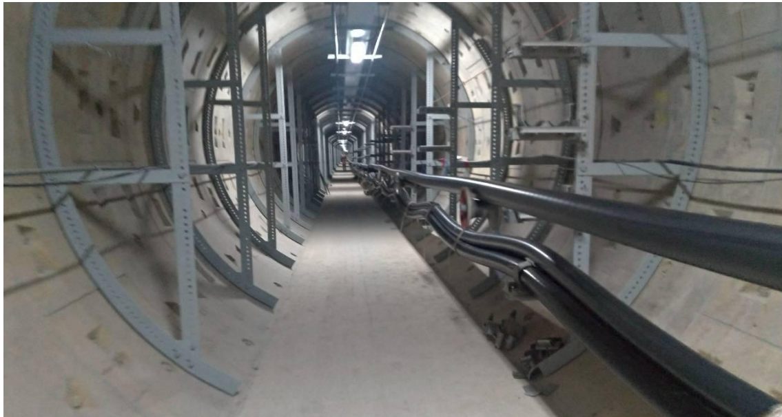
洞道及有附屬機電之明挖洞道所有金屬支柱接地
