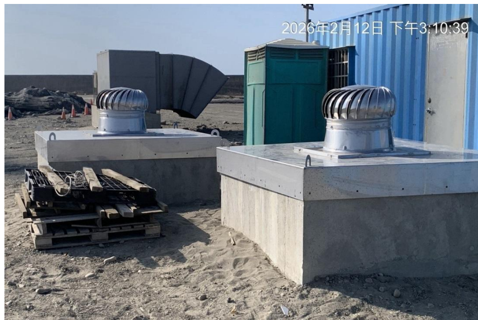
通風換氣裝置
