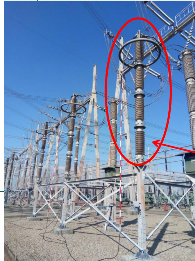
變電所出口處
