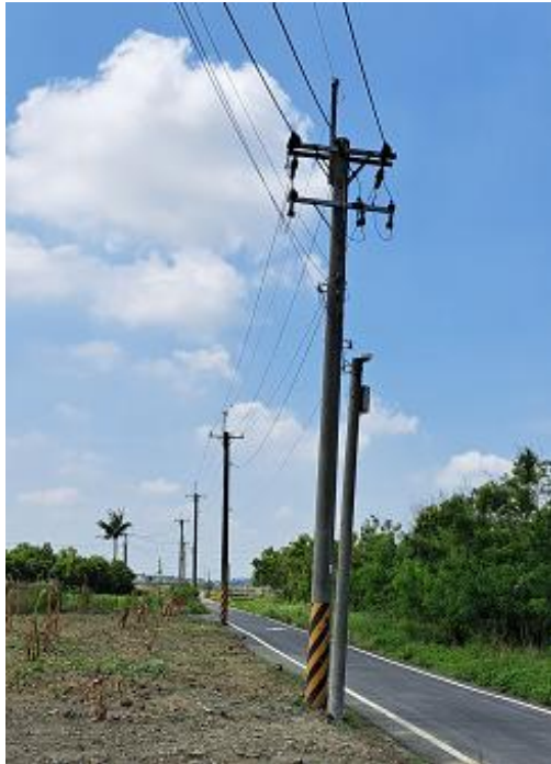
每四支電桿做接地
