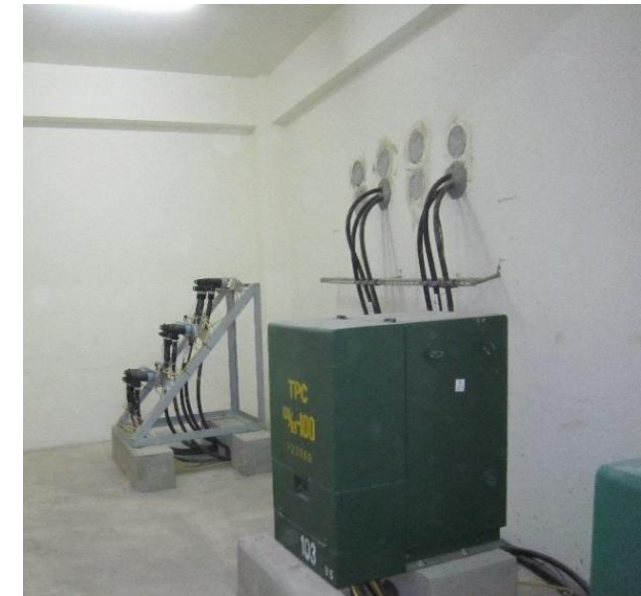
地下配電場所
