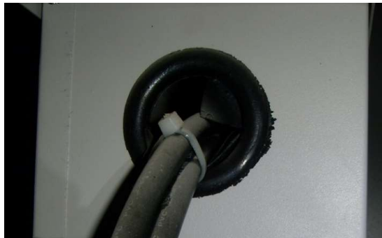
電纜穿越金屬板設置之保護套可避免電纜遭受損傷
