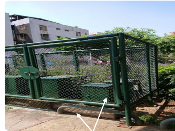
防護裝置 (圍籬、車擋欄杆)
